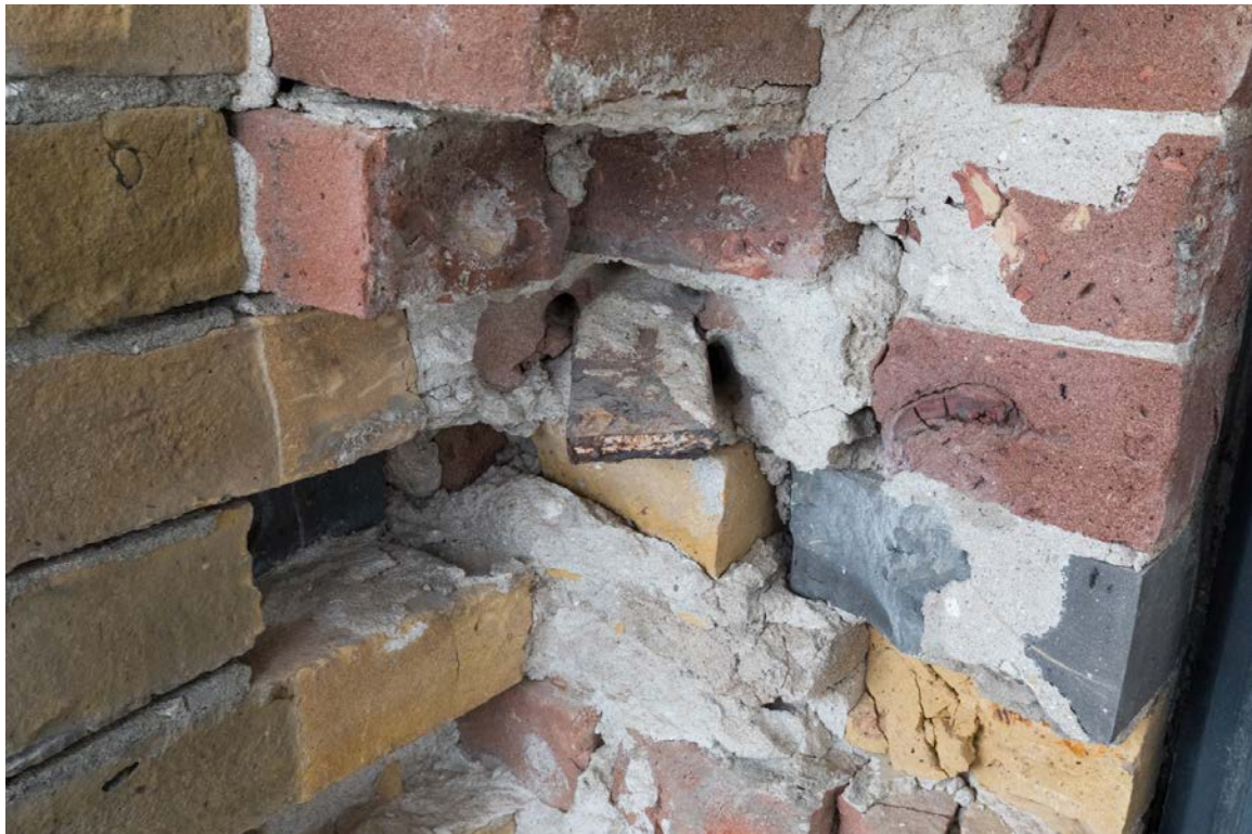
Roestend ijzer achter het metselwerk doet het metselwerk scheuren
