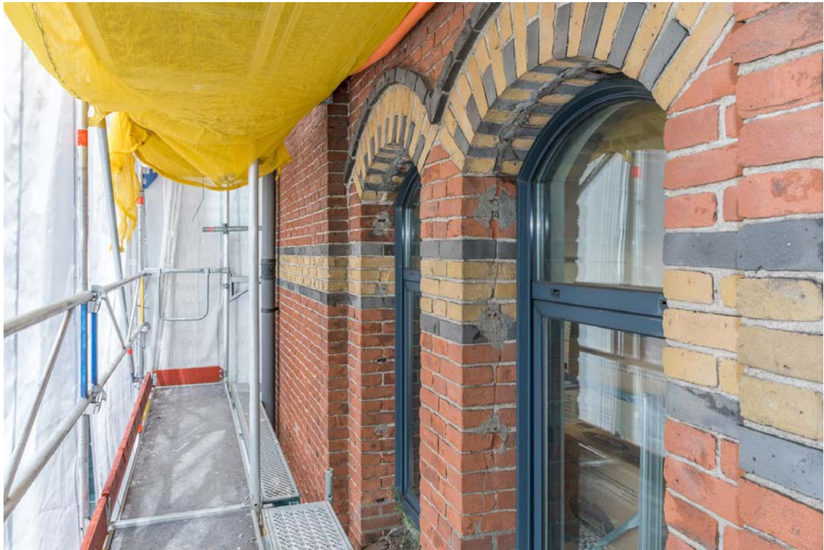
Voor het verwijderen van het ijzer, let op de scheuren rondom de ramen
