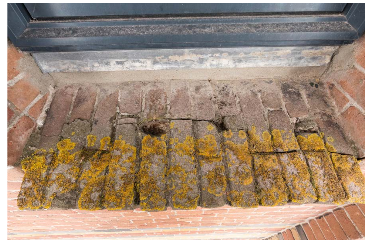
Achtergebleven ijzer doet het metselwerk scheuren
