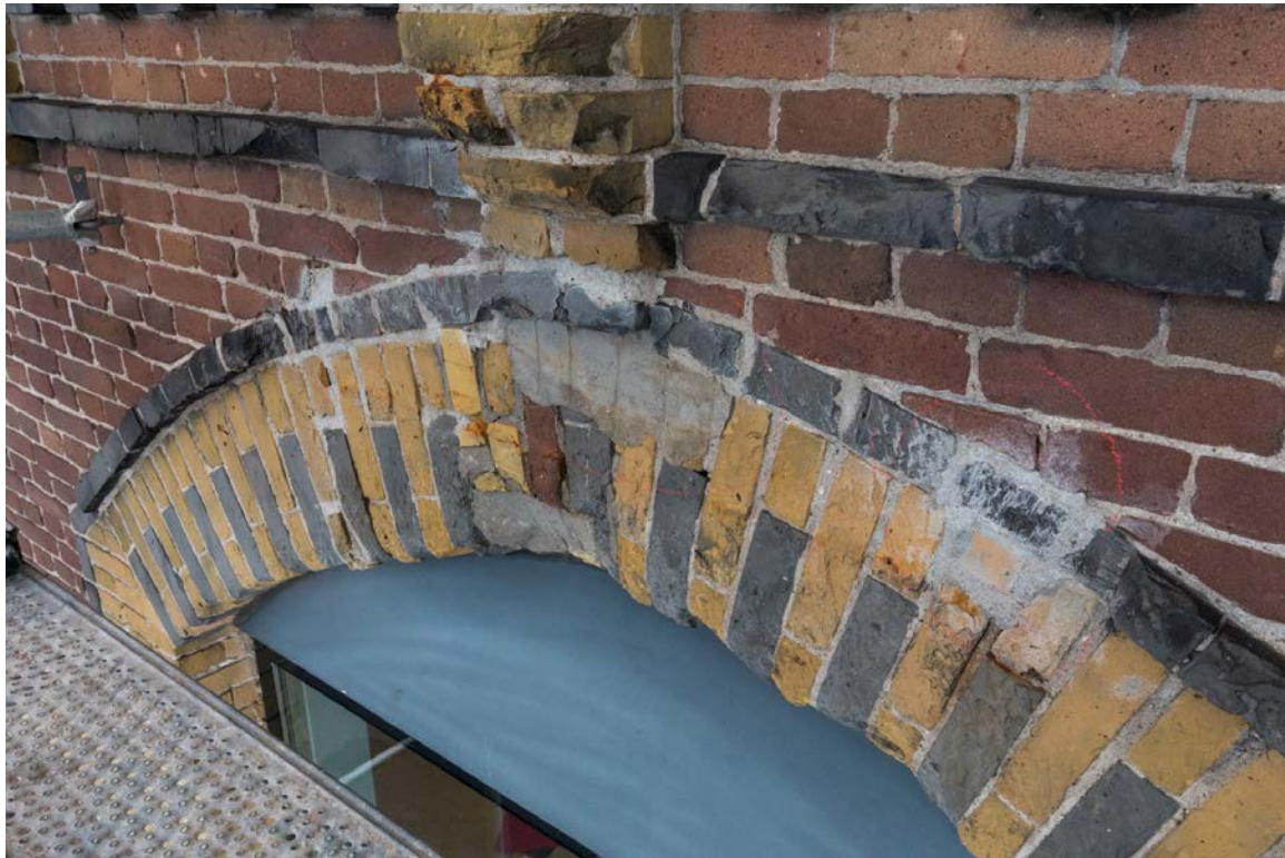
Gevelschades en oude reparaties
