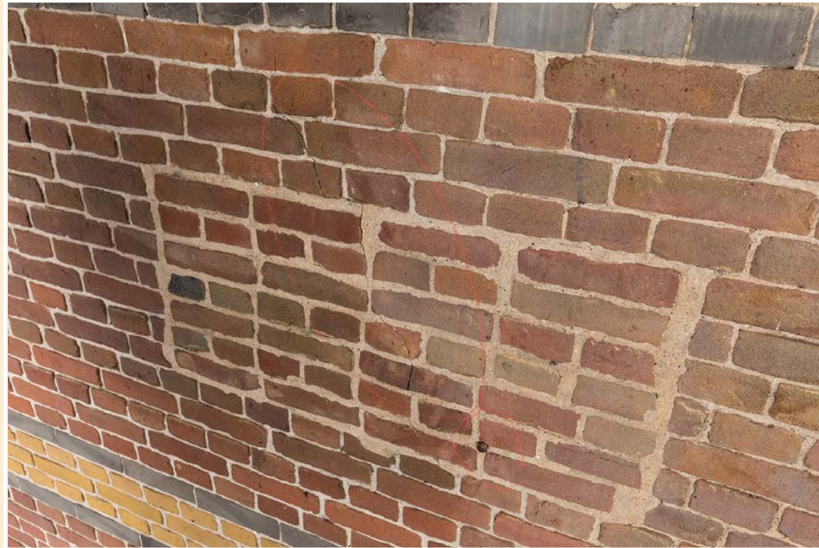
Een scheur in het metselwerk
